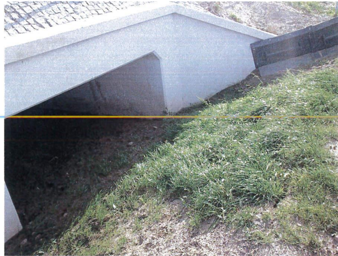
Zbyt stroma strefa najścia do przepustu P19.
