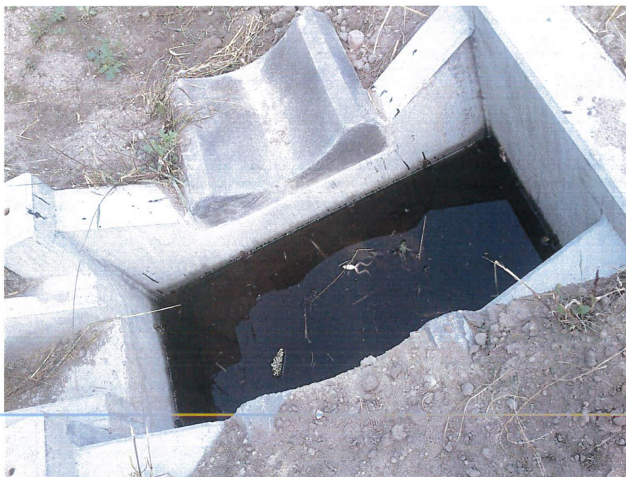
Uwięzione płazy w osadniku przy P24.
