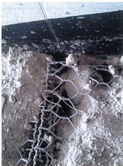
Niedokładne pokrycie gabionów stanowiące pułapkę dla zwierząt.
