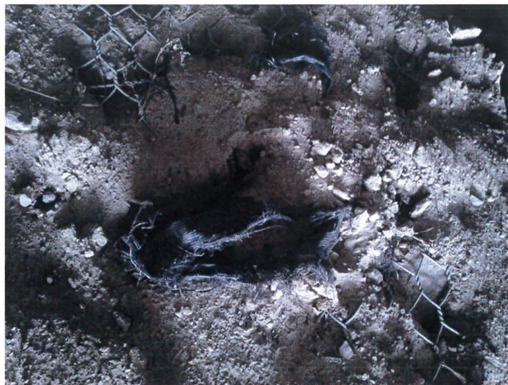
Pozostałości worków w obrębie pól w przepustach P22 i P23.
