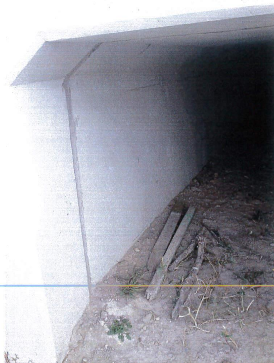
Odpady w obrębie przepustu P24.
