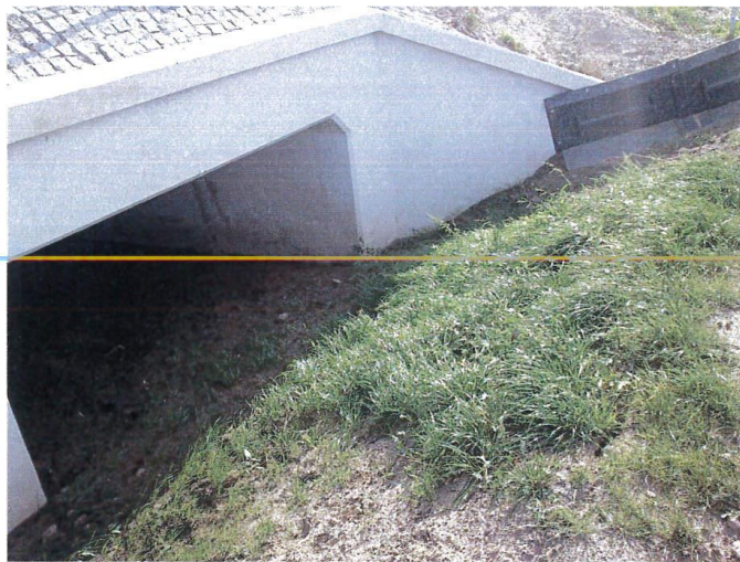
Zbyt stroma strefa najścia do przepustu P19.
