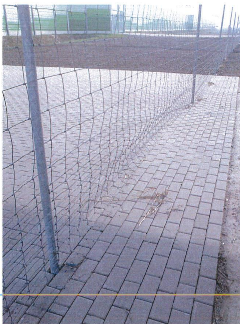
Brak wkopania siatki w rejonie obiektu WD 227 km 268+182,06.
