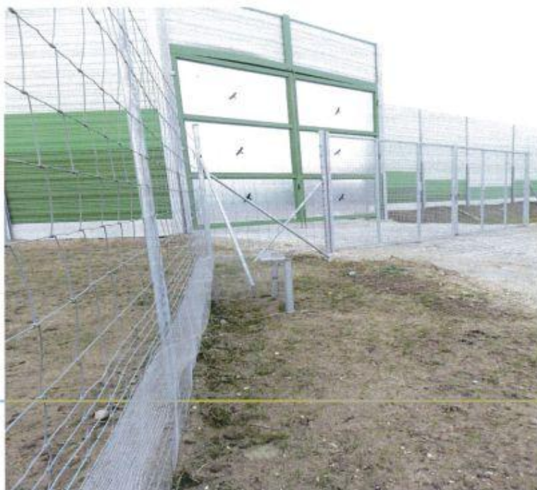
ogrodzenia przy bramie ewakuacyjnej WJA266L
