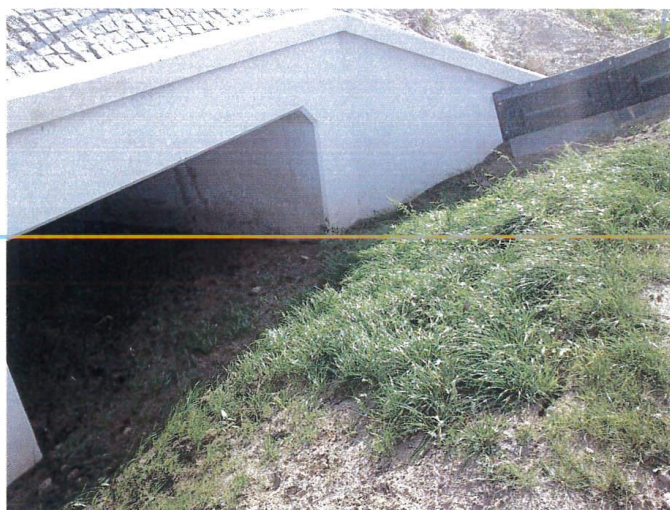
Zbyt stroma strefa najścia do przepustu P19.
