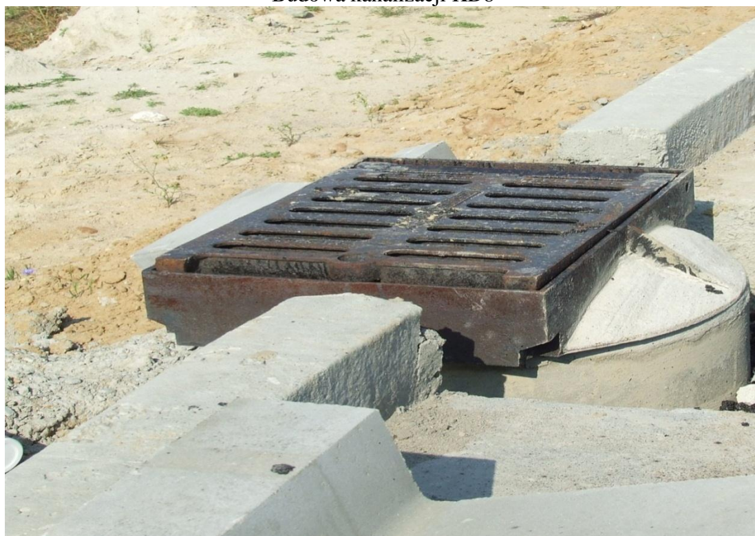
Wbudowany żeliwny wpust ściekowy
