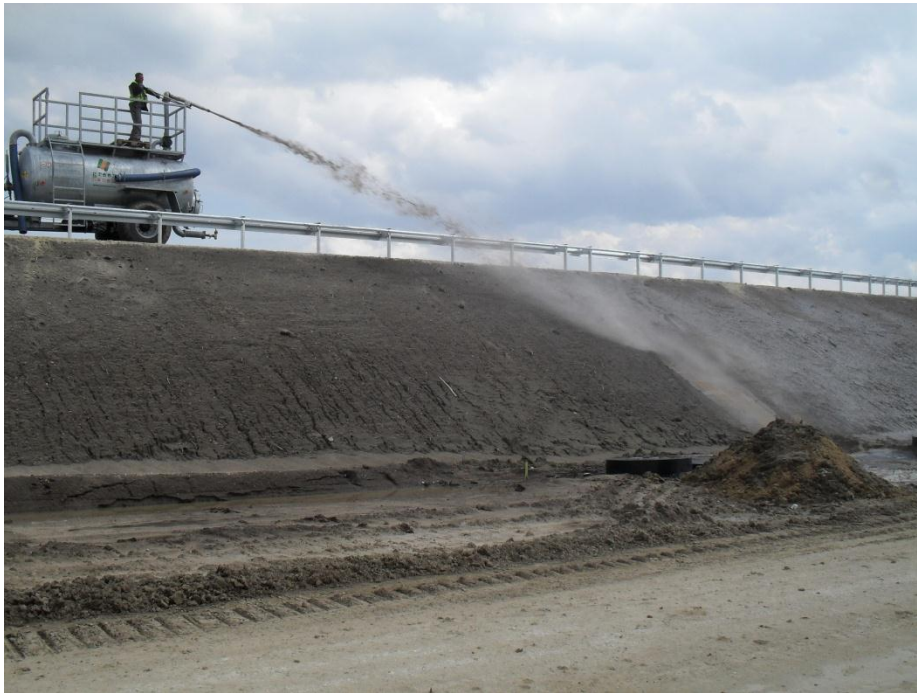
Fot2. Hydroobsiew, km 283+ 100.
