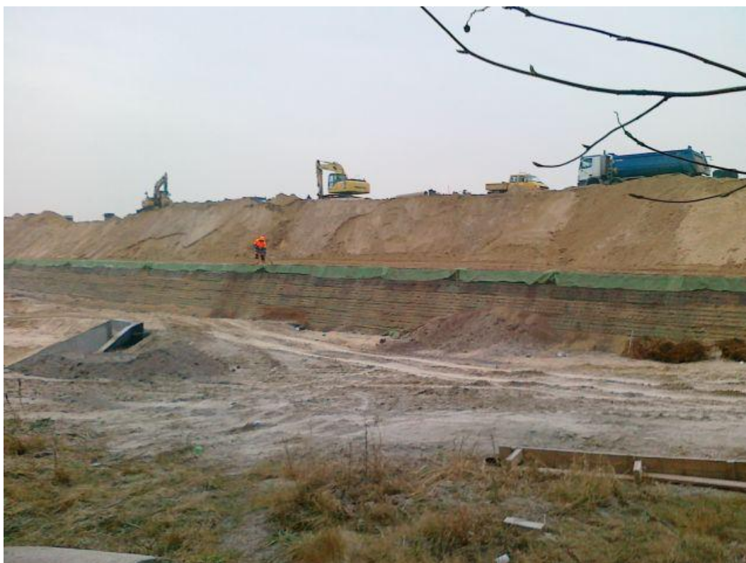
Zdjęcie 3. Skarpa zbrojona stalą, km 290, str. L, 21.12.2011
