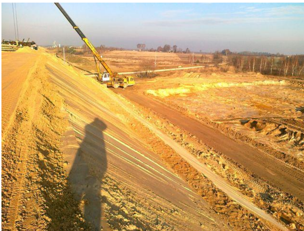
Zdjęcie 5. Skarpy nasypu przed WA-234, str. L, 12.12.2011
