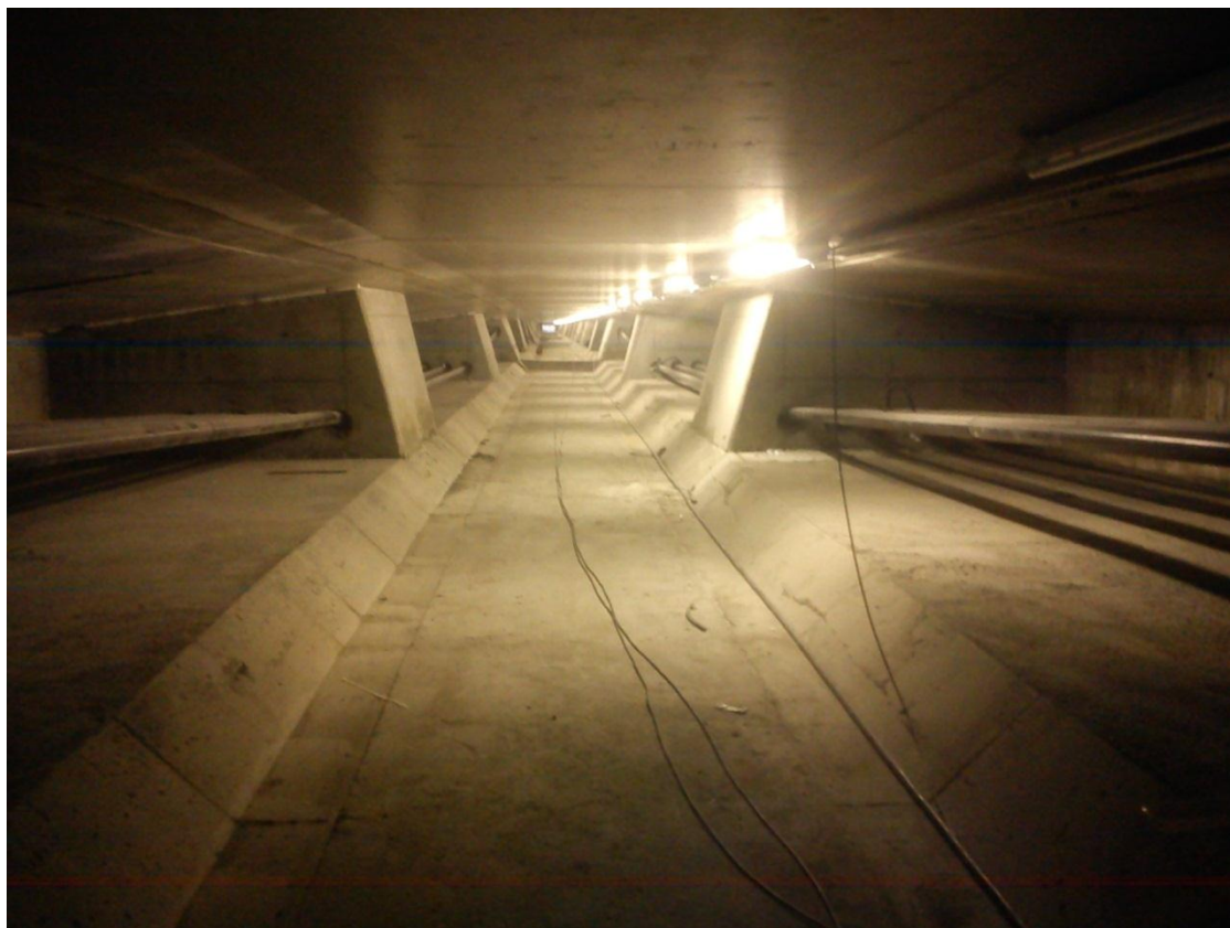
Fot. 8 Kable sprężające zewnętrzne poprowadzone wewnątrz skrzynki ustroju nośnego estakady E-221 18.01.2012
