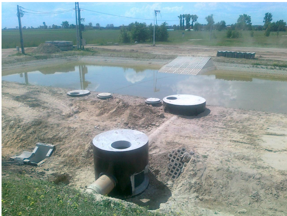
Fot. 15 Zbiornik 41 z układem separatorów 28.05.2012
