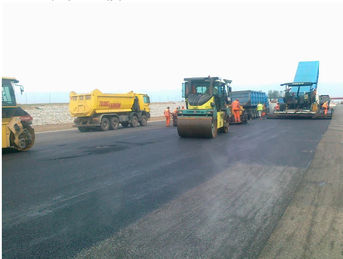
Fot. 8 SMA przejazd awaryjny 03.07.2012
