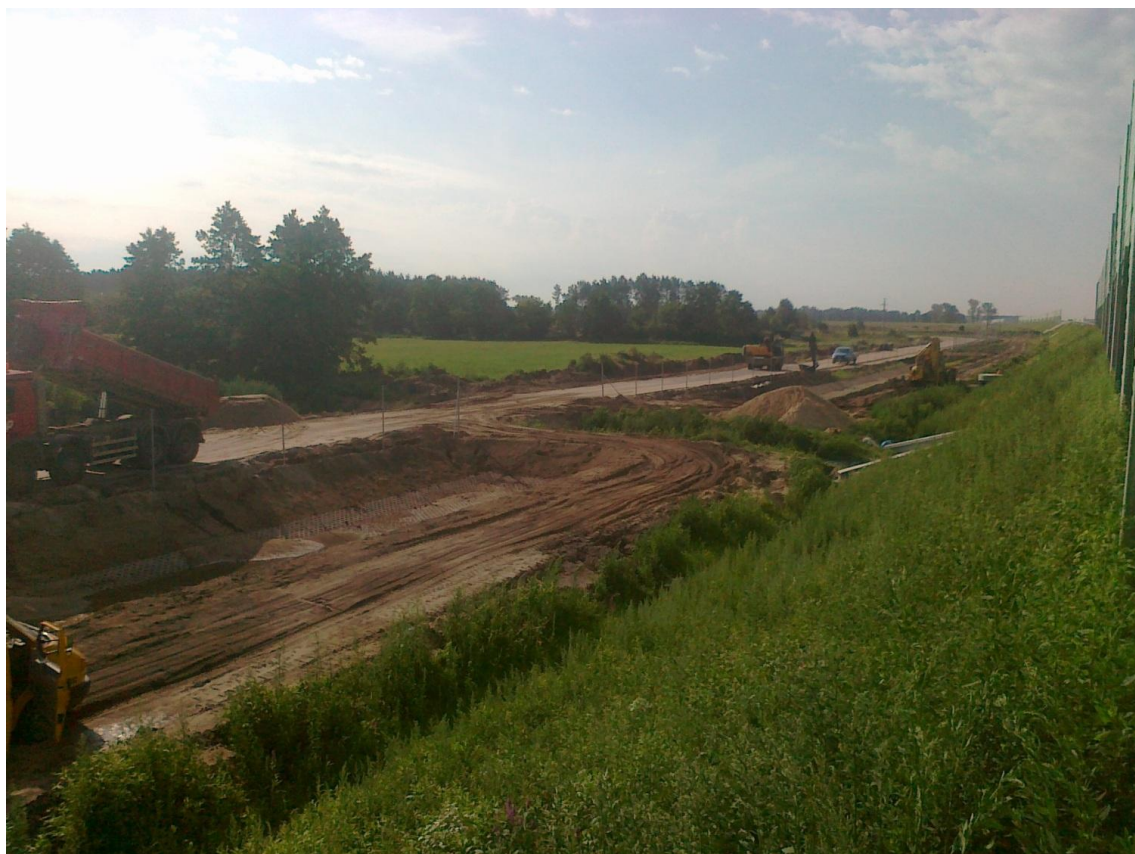
Fot. 15 Zbiorniki 35 i 37 09.07.2012
