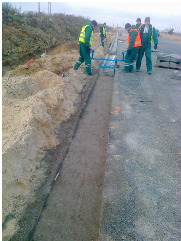
Fot. 4 Ścieki przykrawężnikowe 268+400 06.12.2012
