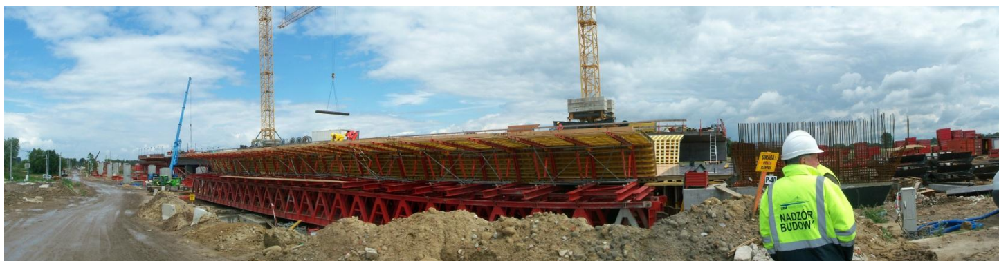
Fot. 7 Widok Estakady E-221 od strony podpory nr 40. Widoczny szalunek 1 taktu nitki Prawej 15.06.2011
