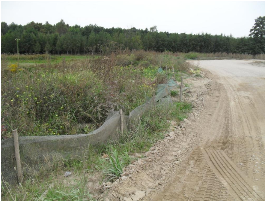
Fot3. Zniszczone płotki herpetologiczne w km 277+000.
