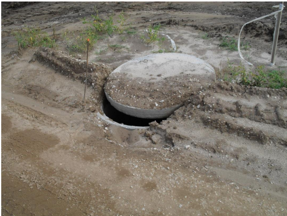
Fot3. Niezabezpieczona przed płużami studzienka kanalizacyjna km 281+250.
