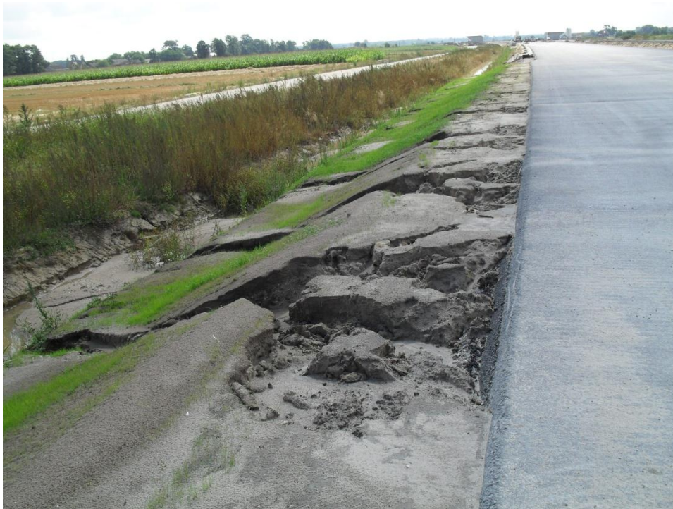
Fot 4. Zniszczenia nasypów po intensywnych opadach km 281+700
