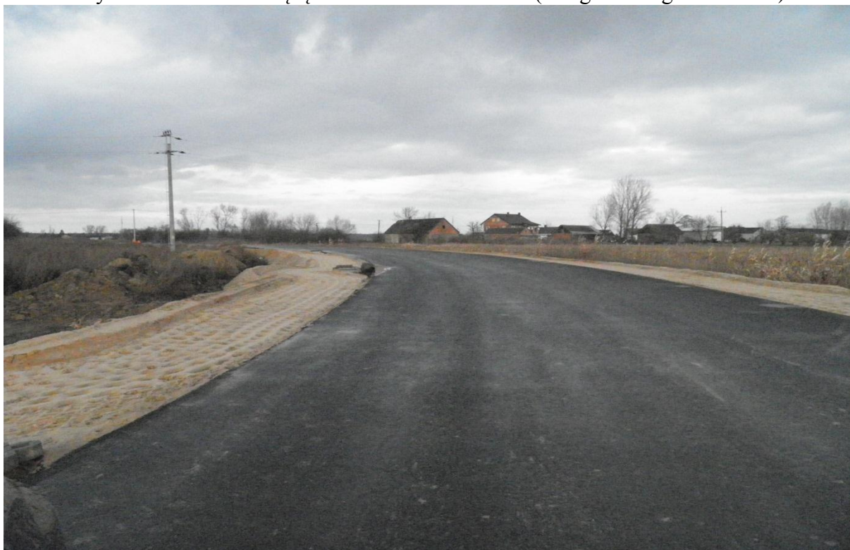
Wykonana warstwa wiążąca droga nr 2124E (pod obiektem WA 208) kategoria drogi KR3-KR4
